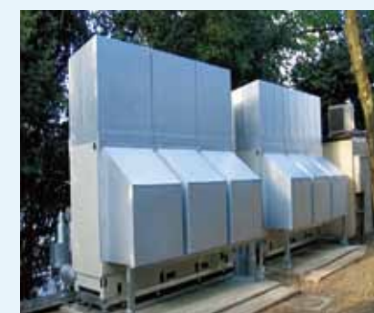
室外機サイレンサー
