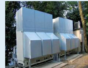
室外機サイレンサー
